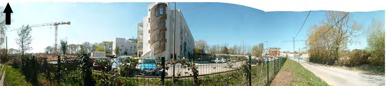
vue sur des opérations de logements en cours de réalisation au sud de la ZAC
