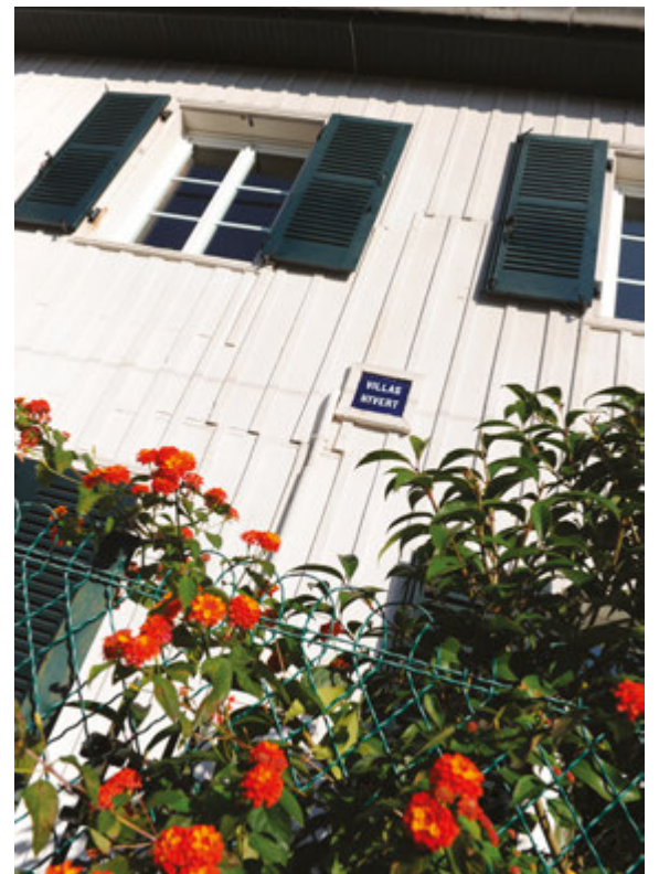
Façade en bois caractéristique de l'ancienne « Ville en bois », XIX e siècle.
